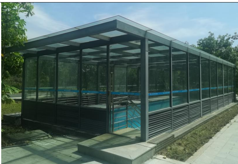
中德四大中心生活污水一体化处理站
